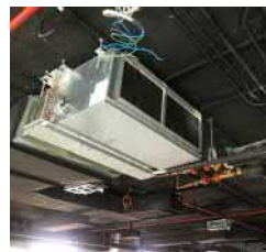
Fan Coil Unit
