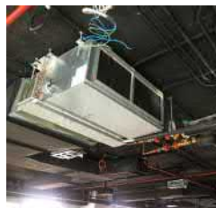
Fan Coil Unit
